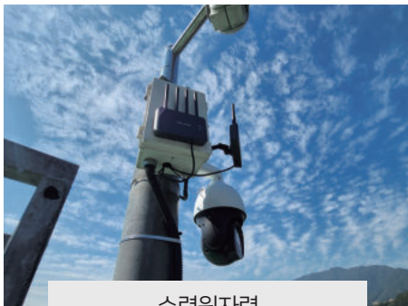
수력원자력 CCTV 납품 및 설치 사진
